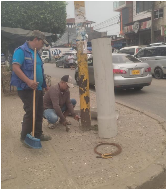
MANTENIMIENTO DE SEMAFOROS
